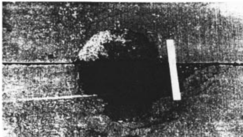
Figura 36. Ruperea dalei la rost – nivel de gravitate mediu
