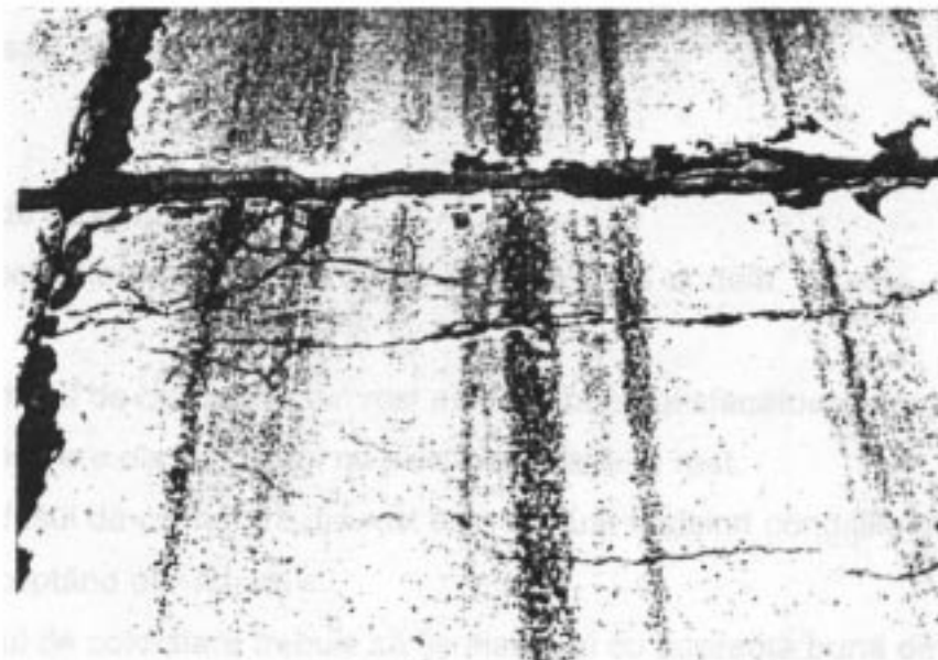
Figura 13. Fisurare datorită îngheț –dezghețului- nivel de gravitate ridicat
