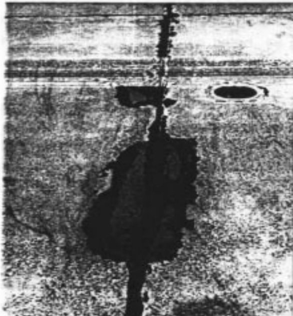
Figura 35. Ruperea dalei la rost – nivel de gravitate scăzut
