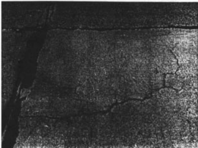
Figura 7. Fisură de colț – nivel de gravitate ridicat
