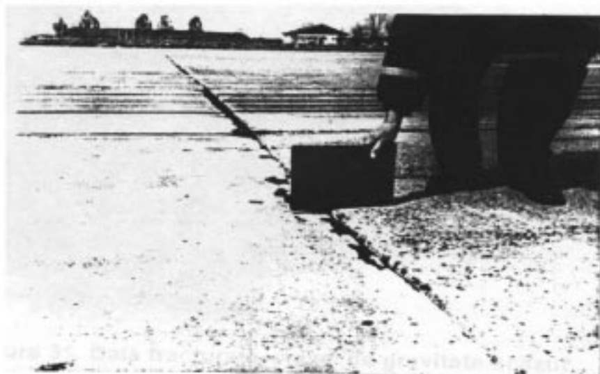
Figura 28. Tasarea diferențiată a dalelor – nivel de gravitate scăzut
