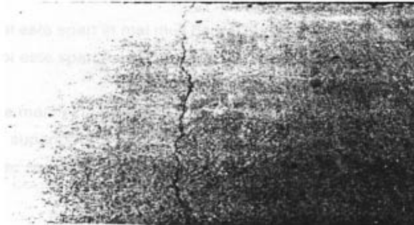
Figura 34. Fisură de contracție
