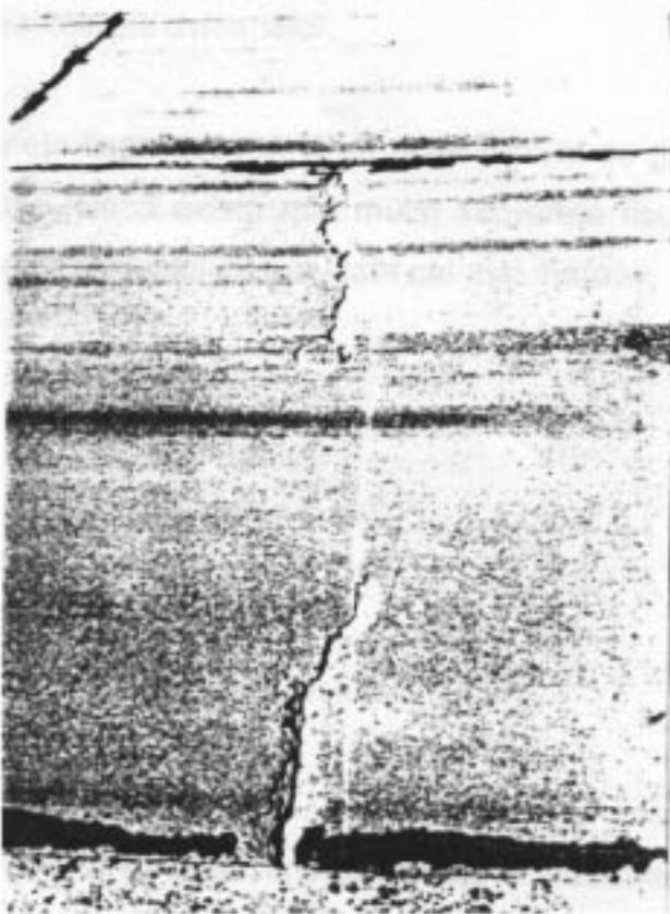
Figura 10. Fisură –nivel de gravitate ridicat
